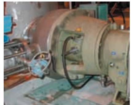
Abb. 8. MCE™-Retrofit -Anwendung in einer Bleichlinie in Schweden.
