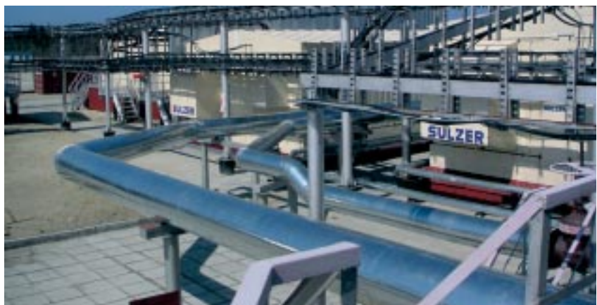
Насосная станция в Западной Сибири - 3 многофазных насоса работают параллельно
